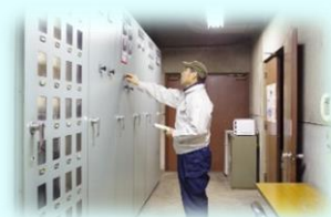
受変電室(メーター確認作業)
